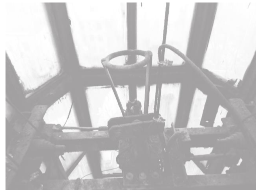
Рис. 4. Каркасно-приставная лифтовая шахта. Состояние оборудования.
