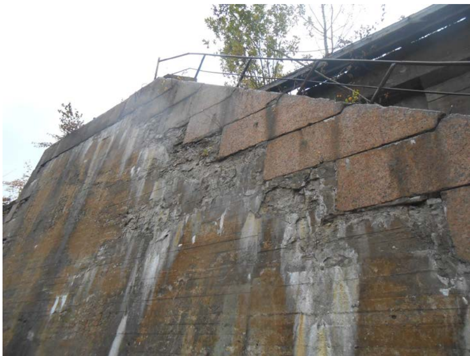
Рисунок 4. Бетонные заплатки на стенах дока.
