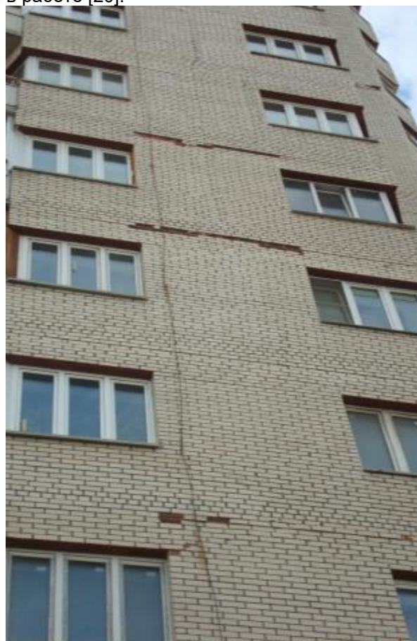
Рисунок 32. Повреждение облицовочного каменного слоя.
