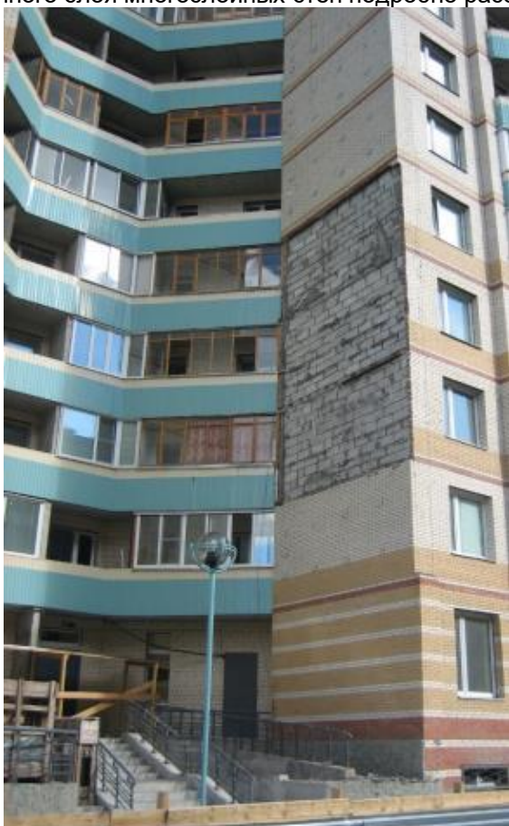
Рисунок 31. Обрушение облицовочного каменного слоя на строящемся объекте.
