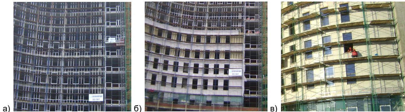
Рисунок 3. Последовательность возведения ограждающей стены по технологии термокаркаса в здании бизнес-центра по адресу г.Санкт-Петербург, ул.Цветочная, д.25, лит Ц.
